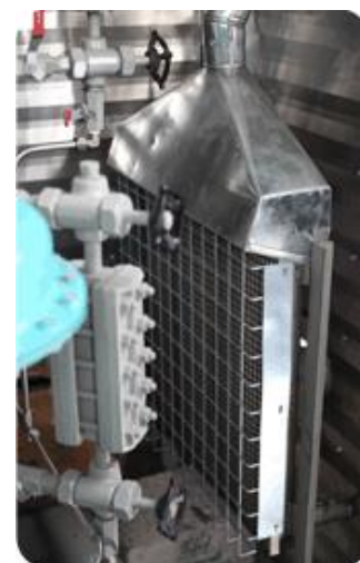
Обогрев узлового перепускного оборудования
